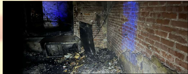
23. November 2023; Brandeinsatz bei den „80er Häusern“ in Gailitz, die Wehren Arnoldstein, Thörl-Maglern, Seltzschach-Agoritschach und die BTF Euro Nova stehen im Einsatz
