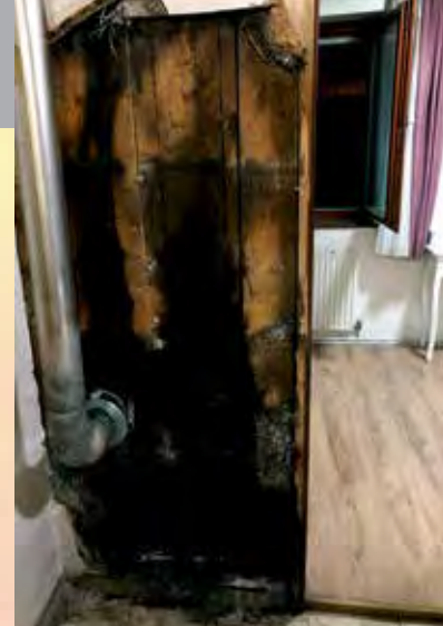
25. November 2020; Zwischenwandbrand in Arnoldstein, die Feuerwehr Arnoldstein verhindert Schlimmeres.
