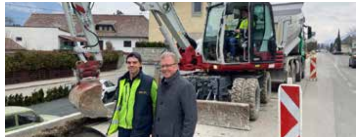
Die Geh- und Radwege befinden sich in Bau, Bgm. Antolitsch überzeugt sich vom Baufortschritt
