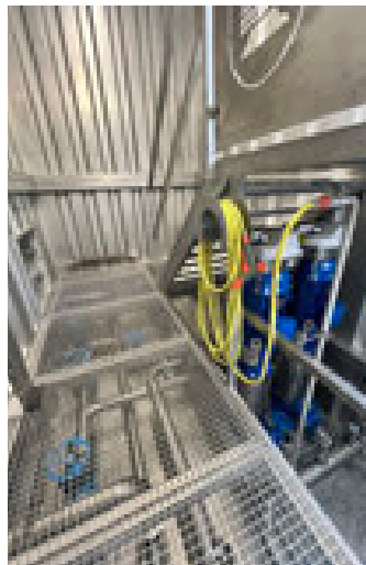
Im Inneren des in Edelstahl ausgeführten Pumpwerkes Pöckau
