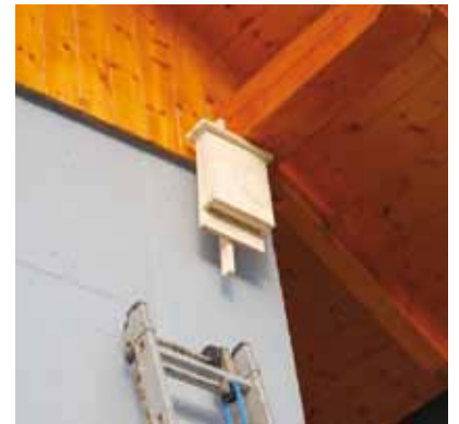
Fledermauskasten am Gebäude montiert
