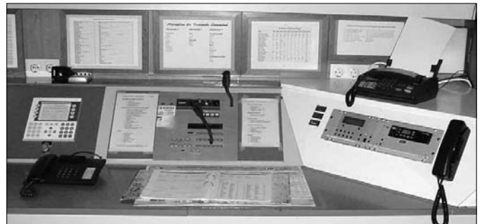
Funkraum der Feuerwehr Lavamünd
