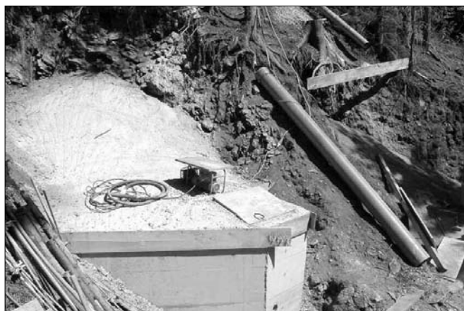
Durch den Bau und Einbindung der „Krusch-Quelle“ am Lamprechtsberg wird die öffentliche Wasserversorgung nachhaltig gesichert.
